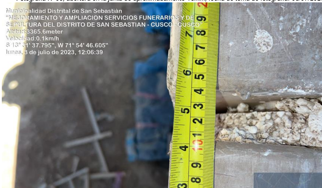
Fotografía N°03, abertura en la junta de aproximadamente 15mm, fecha de toma de fotografía: 03/07/2023
