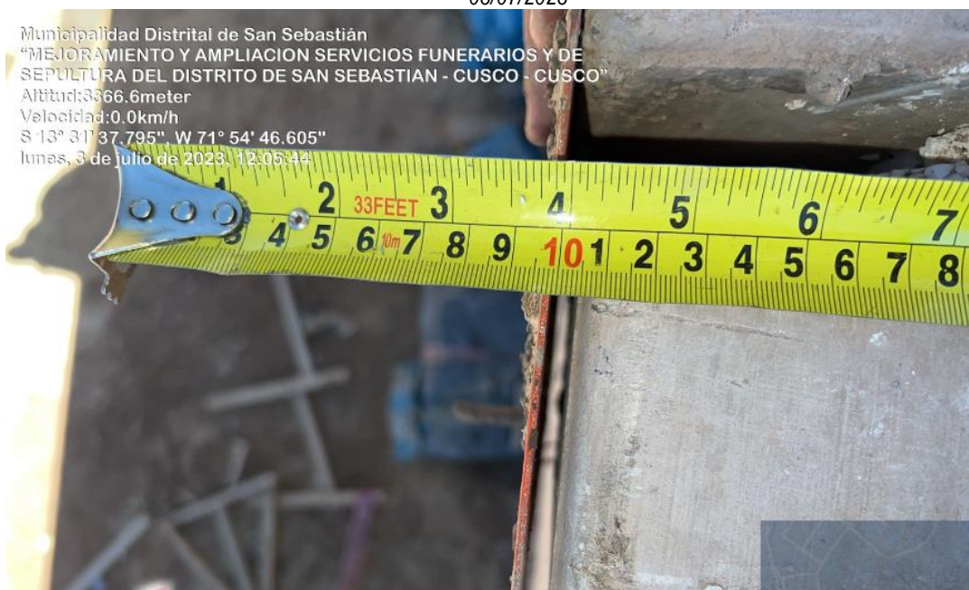
Fotografía N°04, desplazamiento transversal en la junta de aproximadamente 7mm, fecha de toma de fotografía: 03/07/2023
